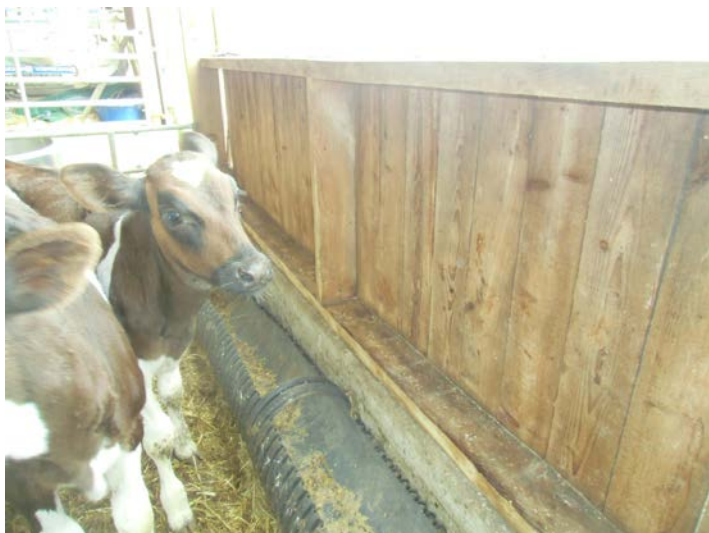
Panneau de bardage démonté du couloir d'alimentation et réutilisé dans l'extension nurserie.
