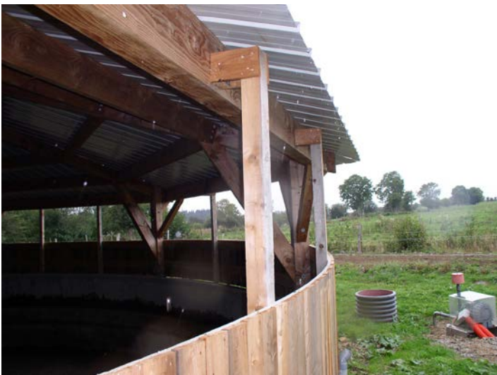
Le bardage de la fosse utilisé comme clôture
