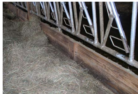
Muret d'auge prévoir un renfort scellé dans la maçonnerie au milieu du panneau de cornadis.
